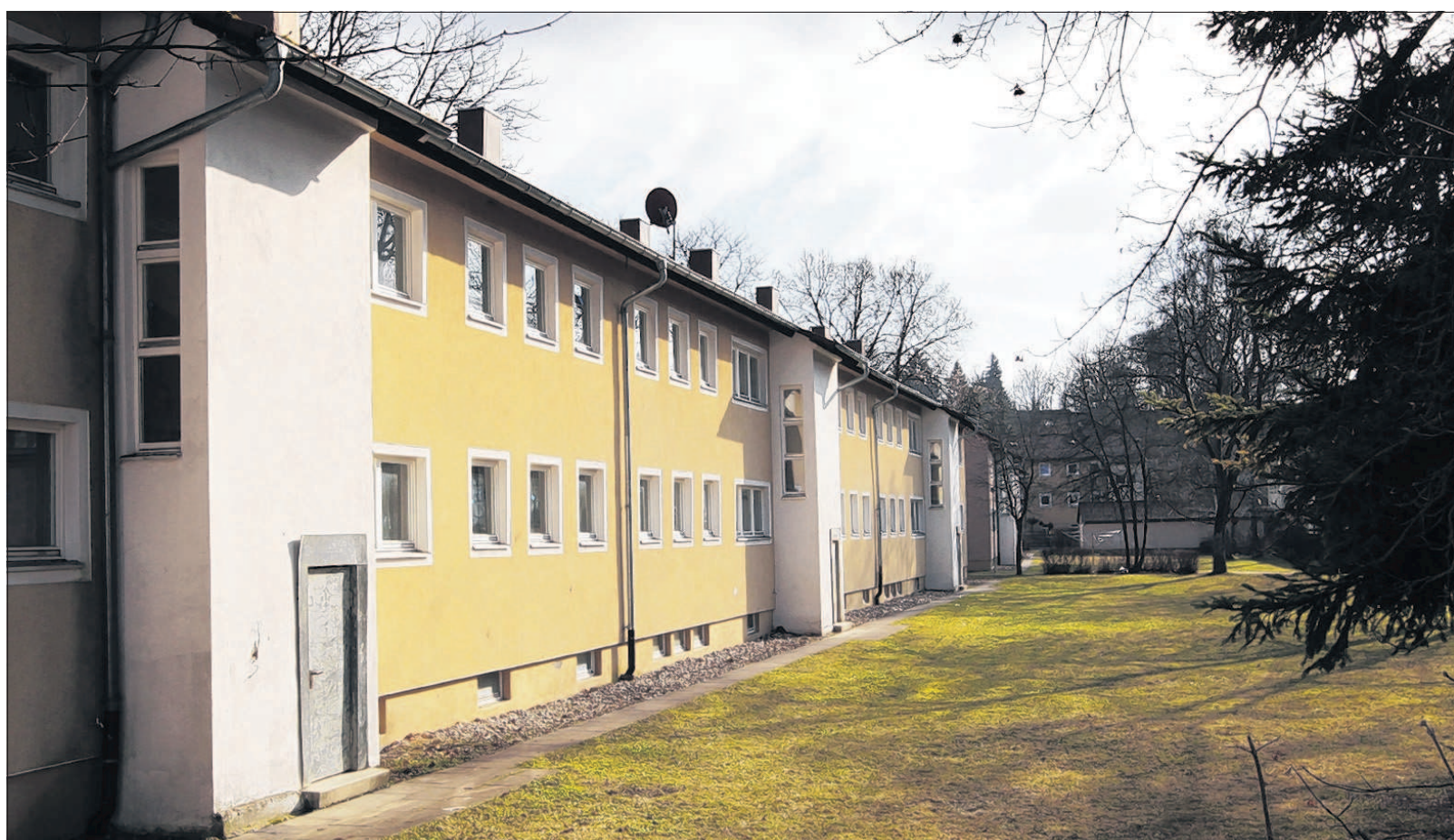
Hier wohnt schon lange niemand mehr: In der Eisenbergsiedlung stehen mehrere Gagfah-Mietskasernen seit Jahren leer. Die Bausubstanz leidet und niemand weiß, was daraus wird.
