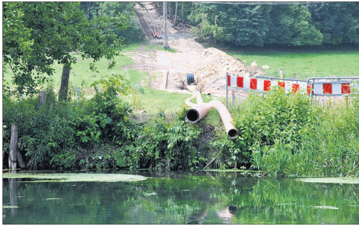
Die Abwasserrohre liegen schon bereit. Nur, wie sie bei Anhausen unter der Brenz hindurch geführt werden sollen, ist noch nicht ganz klar. Die bisher geplante Methode hat sich nun als nicht umsetzbar herausgestellt. Auf die Gemeinde kommen wohl erhebliche Mehrkosten zu. Foto: cw
