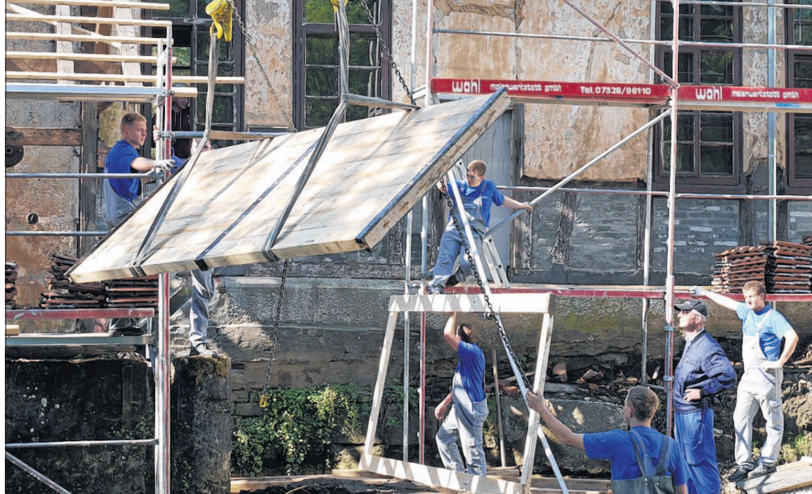
Sperrig und mit einer halben Tonne auch nicht gerade ein Leichtgewicht: der Schieber, mit dem der Zufluss fürs Wasserrad an der Feilenschleiferei gesteuert werden kann. Bis die massive, von Flacheisen zusammengehaltene Eichendielenplatte in den stählernen Führungen platziert war, vergossen die Voith-Azubis so manchen Schweißtröpfchen. Fotos: gst
