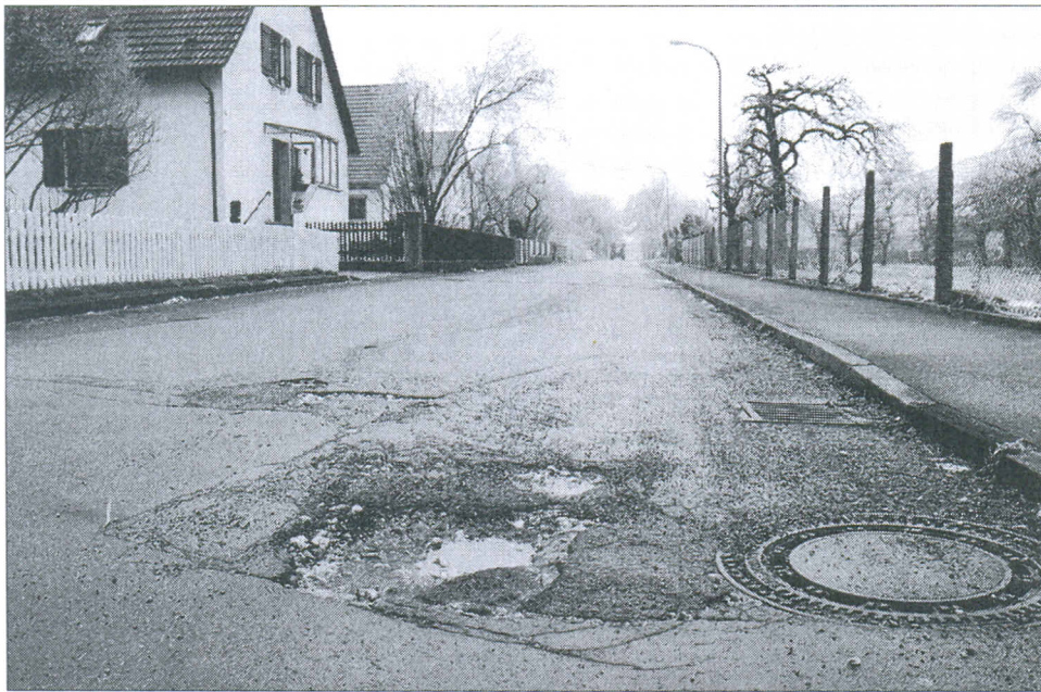
Die Schäden an der Friedhofstraße in Sontheim sind so massiv, dass noch in diesem Jahr wesentliche Teile dieser Straße von Grund auf erneuert werden müssen. Darüber wurde im Gemeinderat diskutiert und kritisiert, dass damit das meiste Geld für den Unterhalt der Straßen in der Gesamtgemeinde für die Friedhofstraße hingeblättert werden müsse. Foto: olv
