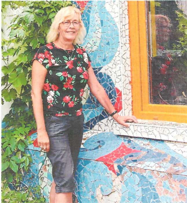
Mit Frostschäden hat Andrea Neumayer immer wieder zu kämpfen. Deshalb tauscht sie beschädigte Fliesen an ihrem Haus gegen spezielle Platten aus, die der Kälte standhalten sollen. Foto: Tina Lischka
